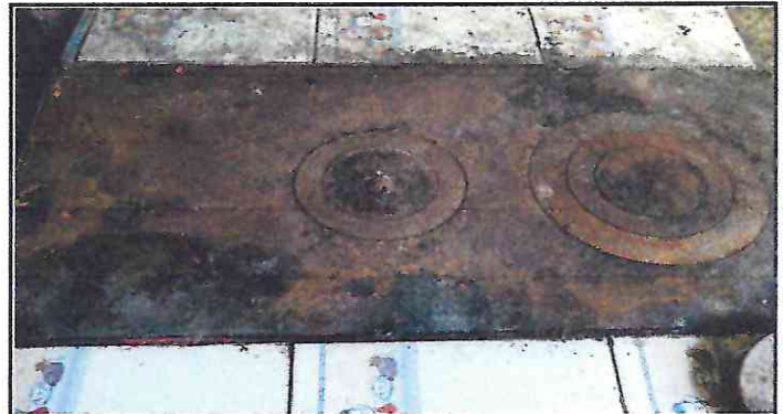
Foto 4: Plancha de Metal en Mal estado
