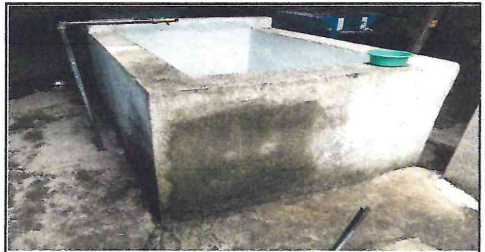
Foto 6: Pila en mal estado
