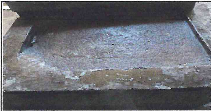
Foto 5: Lavadero en Mal estado
